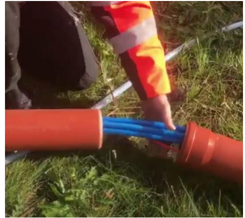
Trækning af luftslanger og kabler i 110 mm føringsrør, før nedgravning af trækrør. Kan også gøres efter nedgravning via træksnor.
