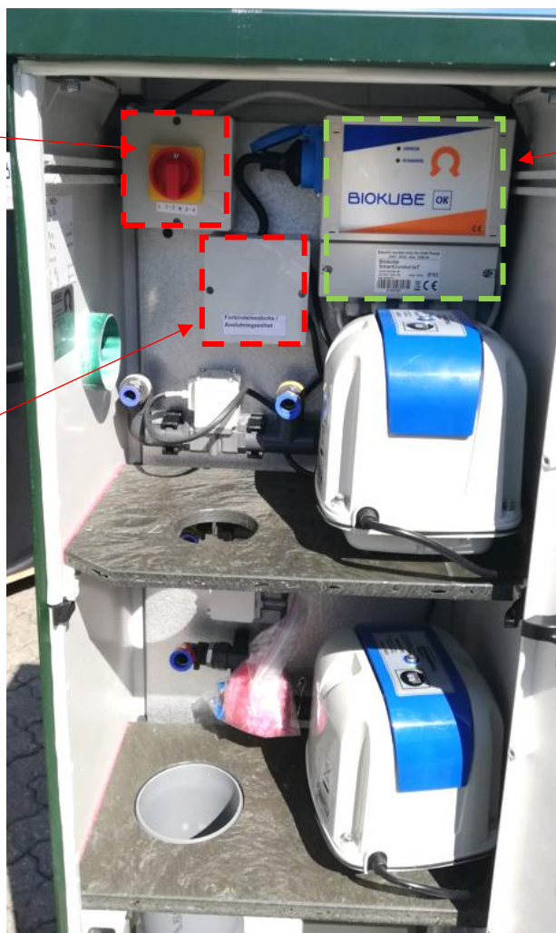
El- og kabeltilslutningspunkter i det eksterne teknikskab
