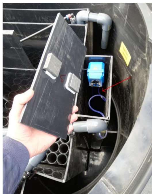
Billedet viser den indbyggede tank til fosforfældningsmiddel med indbygget doseringspumpe
