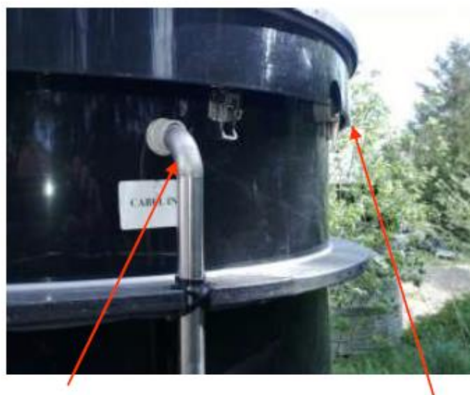
Kabelgennemføring til teknikkasse
