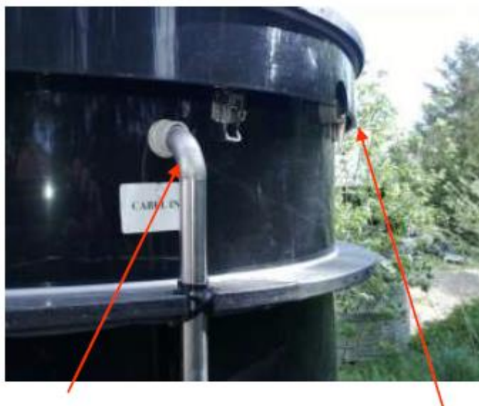
Kabelgennemføring til teknikkasse
