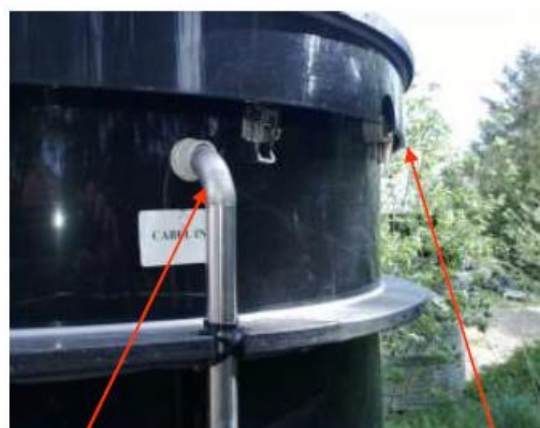
Kabelgennemføring til teknikkasse
