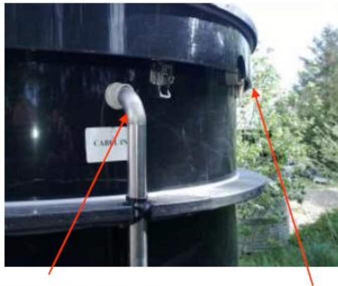
Kabelgennemføring til teknikkasse
