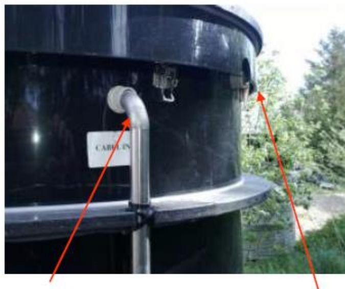
Kabelgennemføring til teknikkasse
