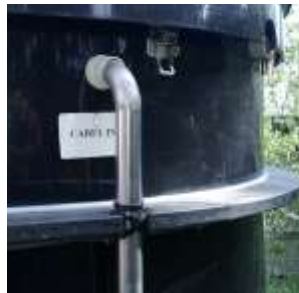
Kabelgennemføring til teknikkasse
