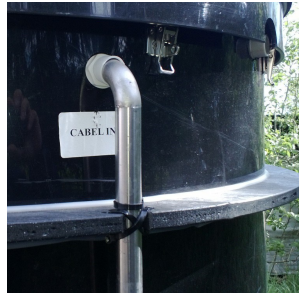
Kabelgennemføring til teknik-kasse
