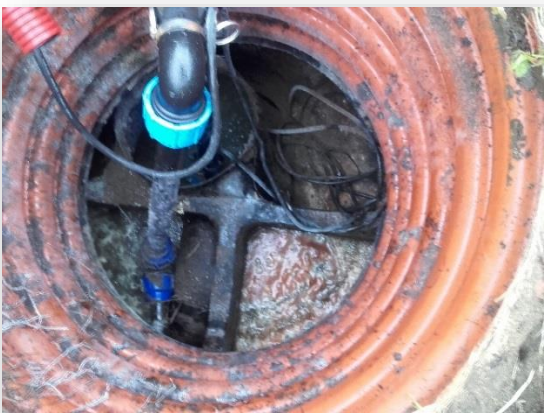
Figur 3: Pumpe sidder i 3. kammer i brønden.
