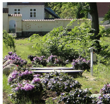
2 x Mars 3000 installeret ved skole i Danmark til 80 PE
