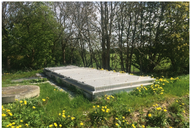
Projekt: Landsbyanlæg Dysted. Kunde: Næstved Spildevand Kapacitet: 200 PE, SOP. Installationsår: 2013
